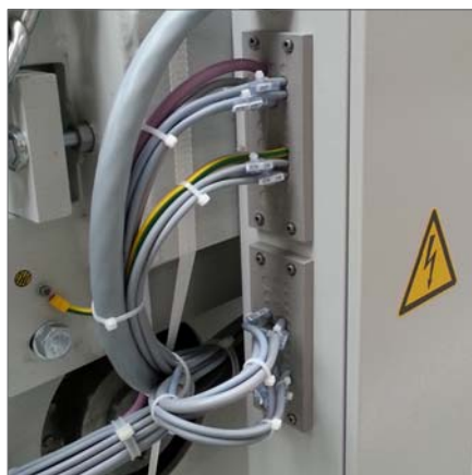
KEL-DPZ 24|x - Strana 62 - 63 Zavedení kabelů s rozdílnými průměry do ovládací skříně s krytím IP65. Volné membrány lze použít pro dodatečnou montáž.
